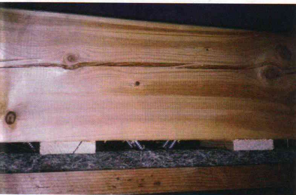
Schubfeste Verschraubung des unterspannten Balken.
